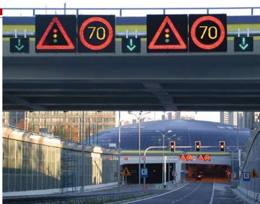
Testowanie podsystemu znaków VMS bezpośrednio przed wlotem do tunelu inicjowane z centrum sterowania ruchem
